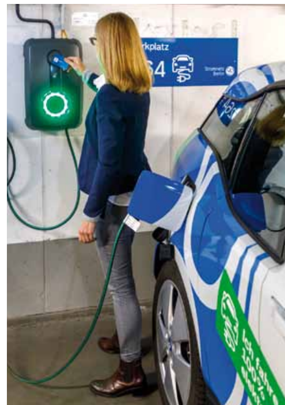
Ladeinfrastruktur bei Stromnetz Berlin
