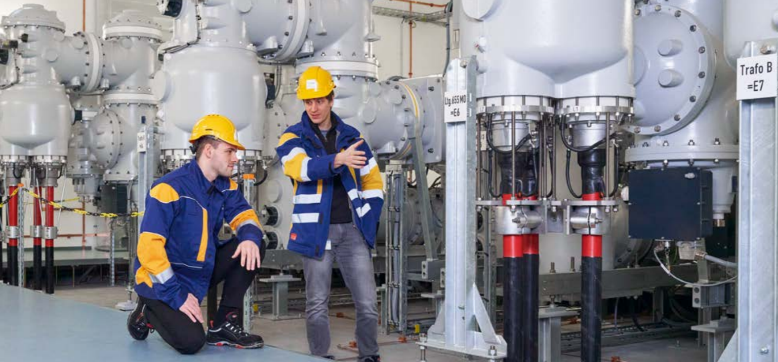
Maximilian Kliche und Kevin Eichhorn in der Hochspannungs-Schaltanlage im Umspannwerk Sellerstraße in Mitte
