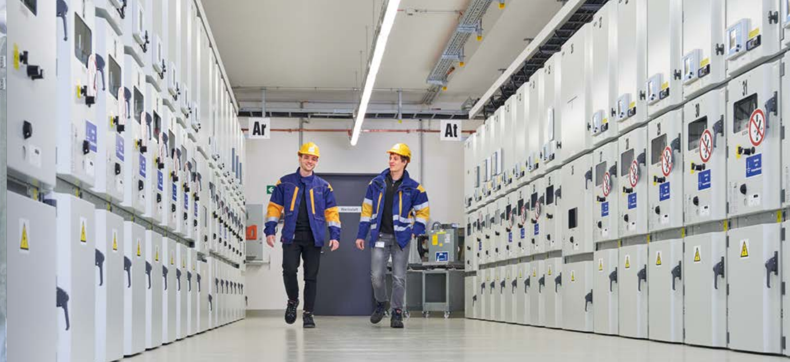
Im Gleichschritt: Die beiden Ingenieure durchschreiten die Schaltanlage für die Mittelspannung.
