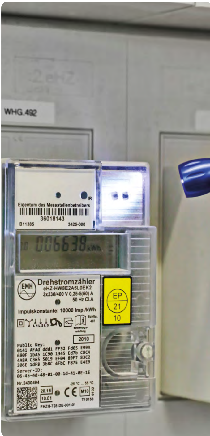
Moderne Messeinrichtung, Hersteller: EMH
