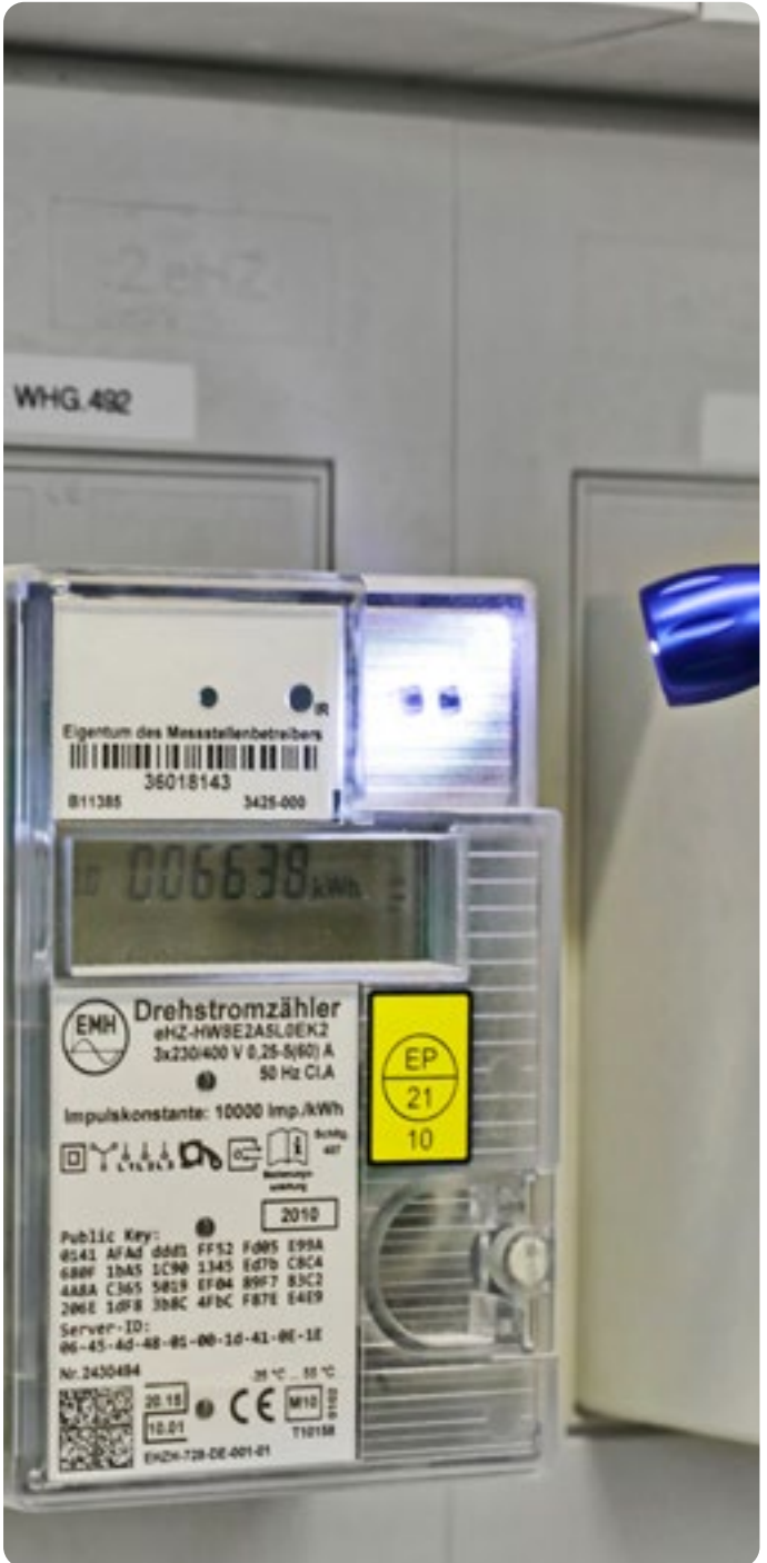
Moderne Messeinrichtung, Hersteller: EMH
